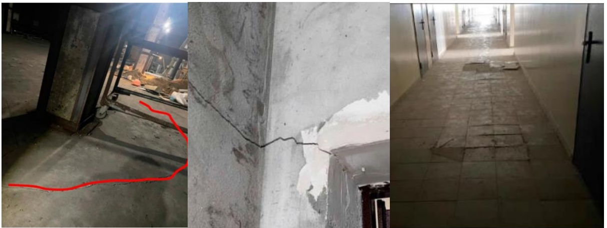
Рисунок 5.10 – Трещины в перекрытии 1 этажа по периметру колон
