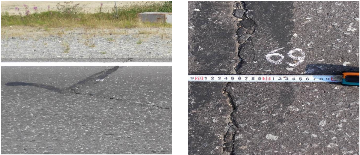
Рисунок 2.48. Трещина на покрытии поперек оси дороги на правой полосе проезжей части с максимальной величиной раскрытия \Delta 25 мм, длина трещины L = 1,44 м (ПК597+42,50)
