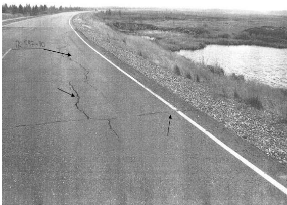
Рисунок 2.13. Продольные и поперечные трещины на проезжей части экспериментального участка
