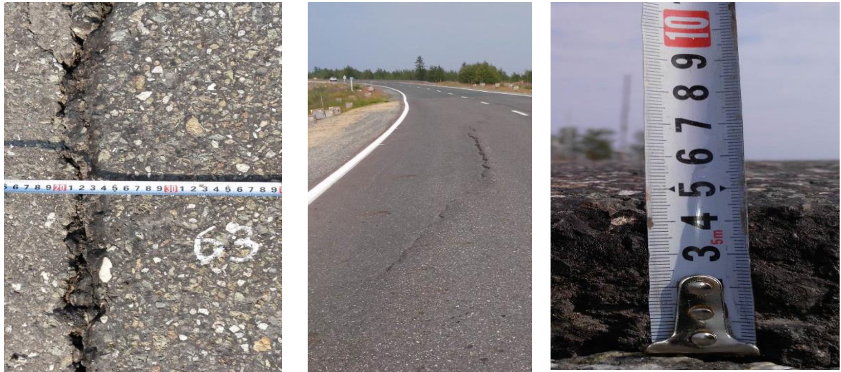
Рисунок 2.42. Трещина на левой стороне проезжей части плавно переходящая в просадку. Максимальная величина раскрытия \Delta 50 мм, длина трещины L = 23,10 м, величина просадки равна \Delta 47 мм
