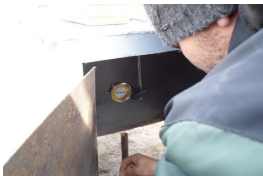
Рисунок 2.27. Установка индикатора часового типа с противовесом в защитном кожухе
