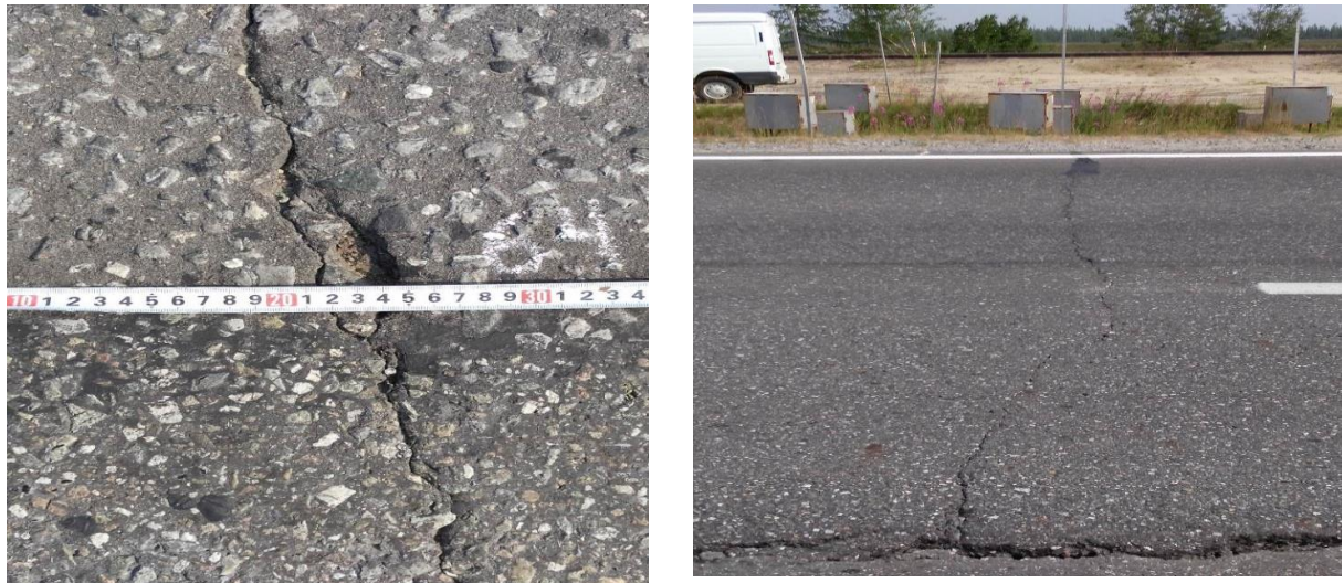
Рисунок 2.43. Трещина на проезжей части поперек оси автомобильной дороги (ПК597+22) с максимальным раскрытием \Delta 40 мм (длина трещины L = 7,20 м)
