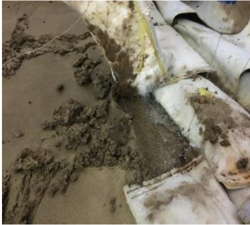
Рисунок 4.36. Сохранение верхней границы ММГ в откосной части сооружения при воздействии неглубоких водоемов с КТМ
