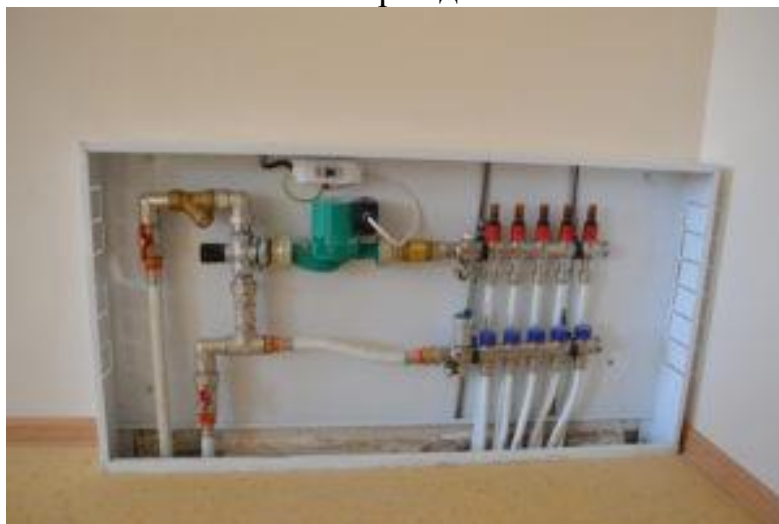
Рисунок 1.4. Коллектор системы теплого пола
